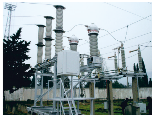
Совместная установка ВГТ-УЭТМ®-110 и ТРГ-УЭТМ®-110
